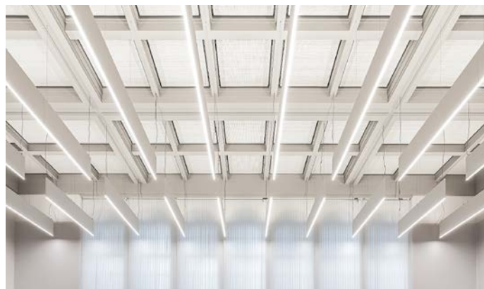
Abb.: Im gesamten Saal wurden 30 Pendelbaffleuchten installiert. Ihr direkt/ indirektes Licht ist getrennt schalt- und dimmbar. Der Abstrahlwinkel von 120° sorgt für eine homogene Lichtverteilung.
